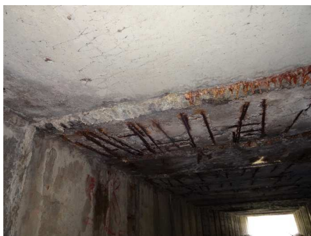
Podhled NK směr k Op2. Tvorba krápníčků a obnažena korodující výztuž na spodního líci 25. prefabrikátu.
