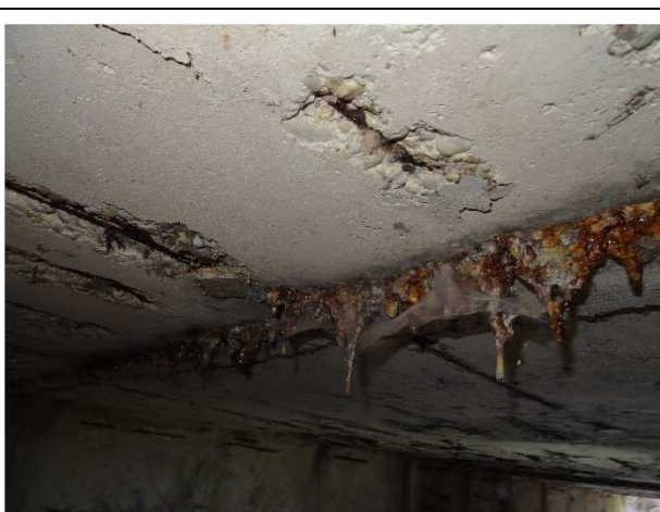
Podhled NK od Op2 k Op1 a ve směru k návodní straně mostu. Tvorba krápníčku ve spárách mezi 14. a 15. prefabrikátem NK.
