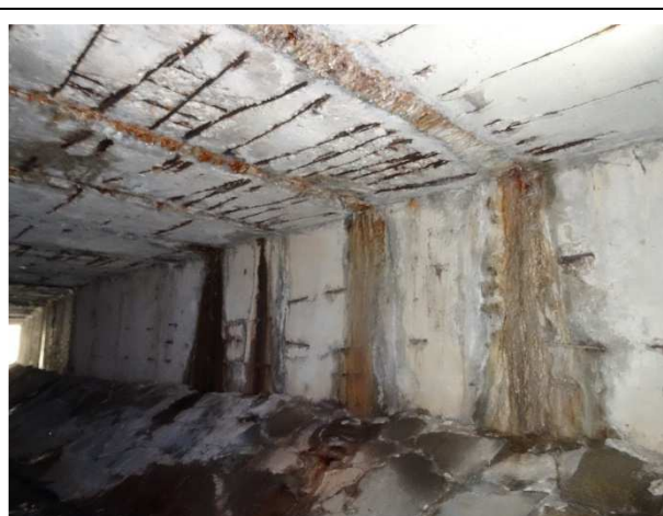
Pohled na Op1 směrem k povodní straně mostu. Zvodnělé plochy v místě spár mezi 24. až 28. prefabrikátem (od návodní strany).
