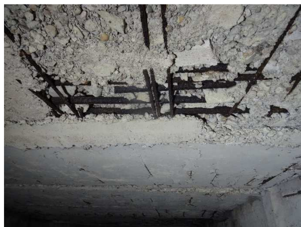
Spodní líc 7. prefabrikátu od návodní strany. Detail štěrkového hnízda s obnaženou a korodující výztuží.
