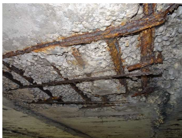
Detail korodující výztuže na spodním líci 5. prefadílci. od povodní strany.
