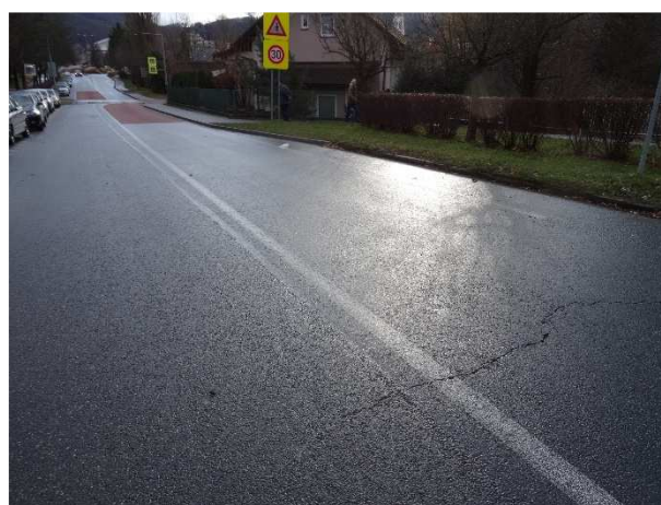
Příčná trhlina v pravém jízdním pruhu blíže k pravé (návodní) straně.
