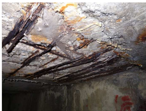
Podhledu 25. prefadílce u Op2 v detailu. Pokročilá degradace betonu, tvorba krápníčků, výluhů. Korozně s odpadávající výztuží.
