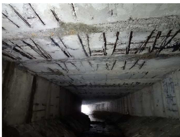
Vlhkostní mapy ve sparách mezi 11. až 13. prefadílcem od povodní strany. Silně zkorodovaná výztuž.
