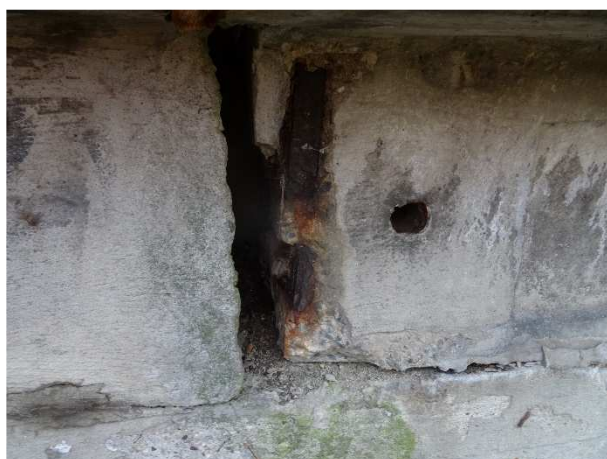
Obnažené kotvy předpětí pravého krajního nosníku v místě uložení na Op1.
