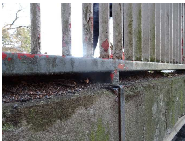
Usazené nečistoty pod zábradlím na levá římse.
