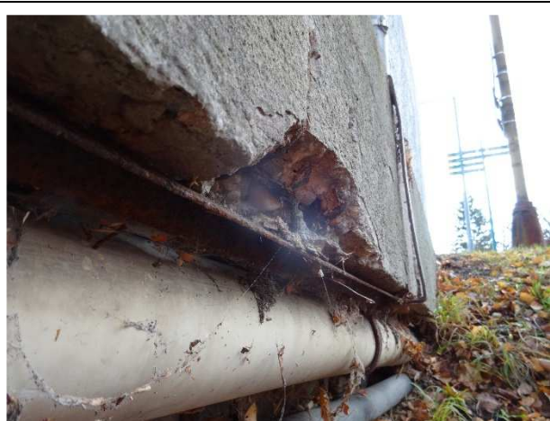
Hlubková degradace betonu ievá římsy křídle Op2 s obnaženou výztuží.
