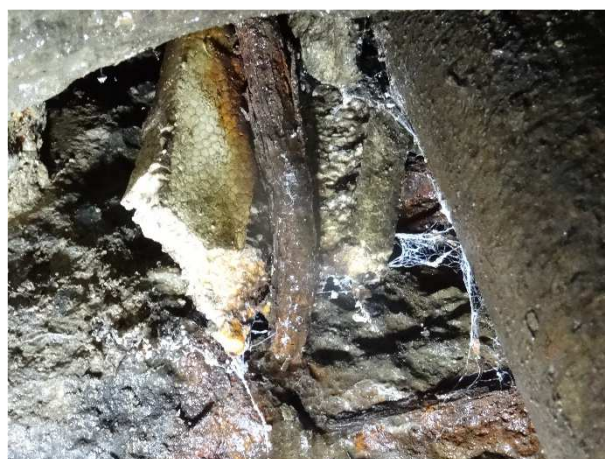
Degradace betonu s obnaženou výztuží v místě prostupu výústní trouby odvodňovače mezi nosníky.
