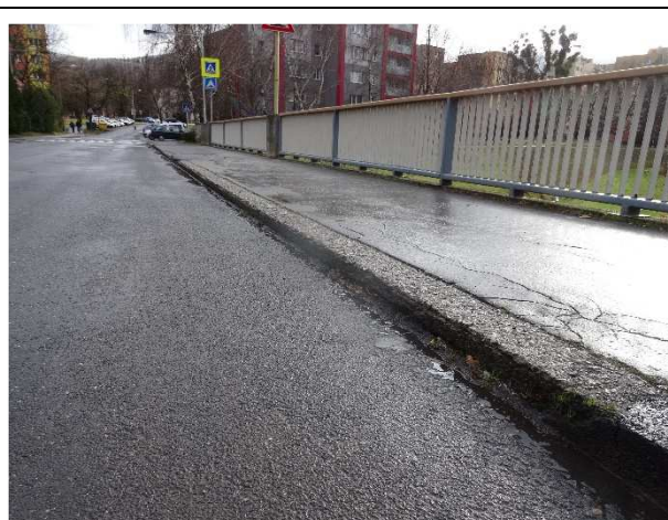
Pravá strana svršku mostu. Degradace betonu chodníkové obruby a neošetřené trhliny v LA na pochozí ploše chodníku.
