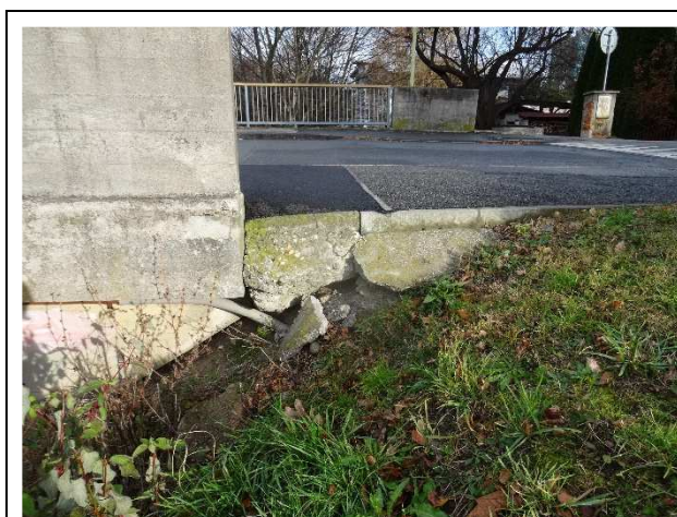
Degradace betonového lože betonové obruby, přechodová oblast u Op3.
