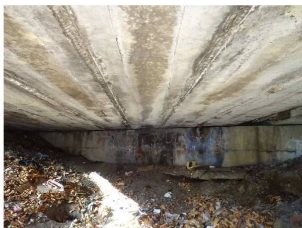
Pohled na Op1 – levý břeh. Patrné obnažení podkladního betonu Op.
