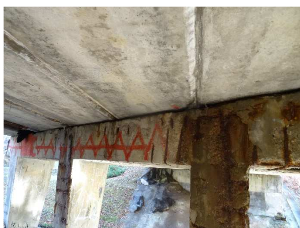
Bližší pohled na rámovou stojku s obnaženou výztuží a smáčením přes její úložnou plochu.
