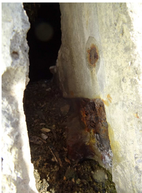
Čelo krajního nosníku nad P2, z pravé strany mostu. Korodující obnažená kotva předpínací výztuže.
