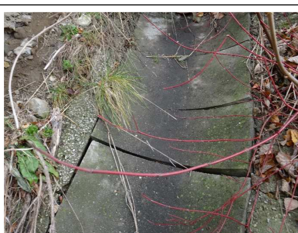
Uvolněné žlabovky odvodňovacího skluzu u Op3.
