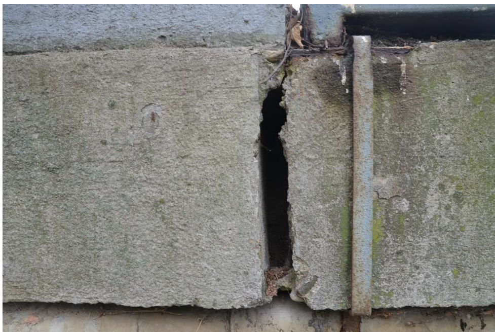
Obr.F86-31 Detail dilatační spáry v pravé římse nad první podpěrrou, levobřežní opěrou. Pohled zprava doleva, po vodě,
