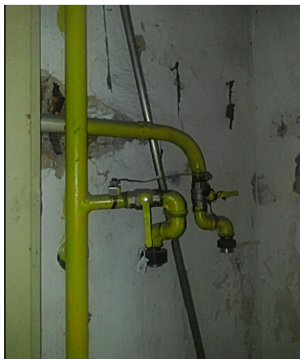
Plynoměrné místo je stávající.
