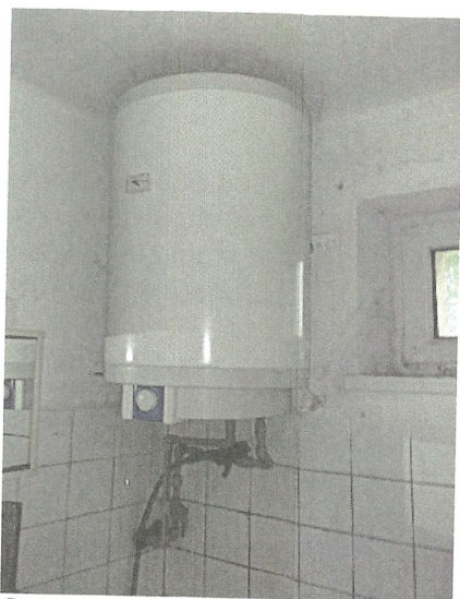
Stávající elektrický ohřivač TUV
