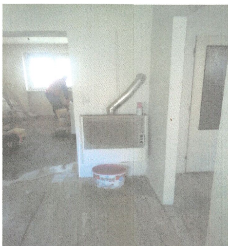
Stávající plynové topidlo
