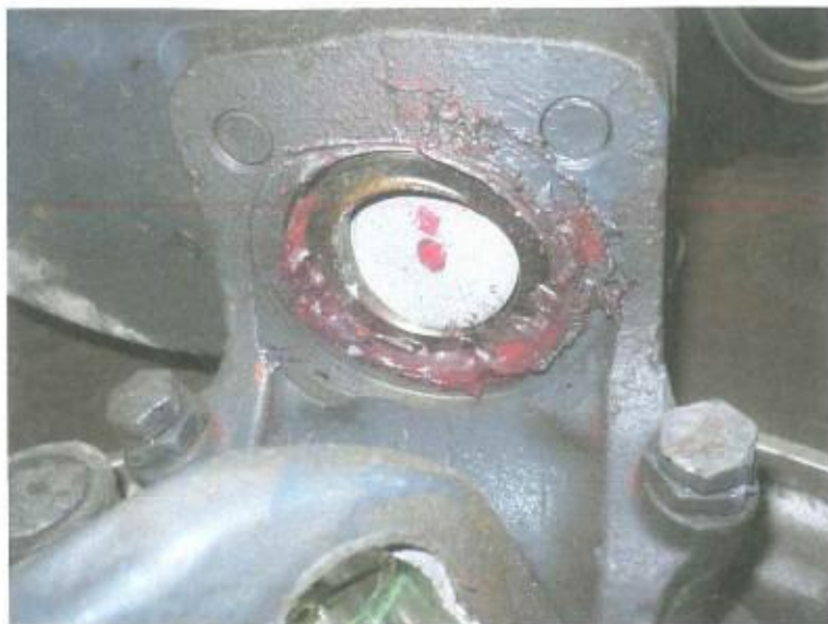
Obr.5 Část horního svislého čepu, která zůstala na páce řízení
