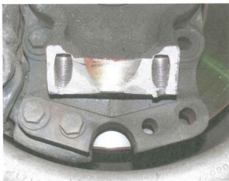
Obr.6 Rozlomené lůžko spodního čepu
