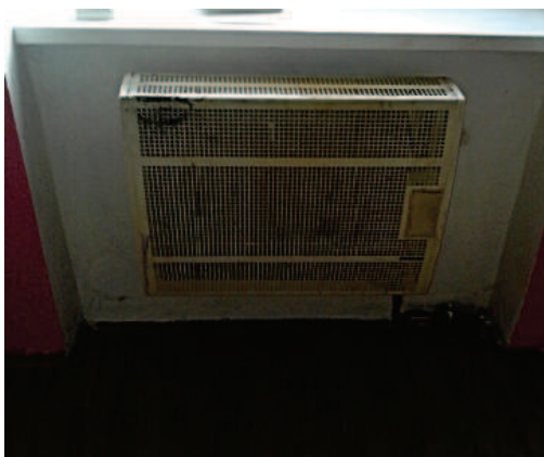
Plynové topidlo 6140 – kuchyně
